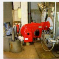
Die Ecojet Powerjet Professional-Produkte werden im laufenden Betrieb auf die Gasleitung gebaut, ein Umbau der Gasgeleiste ist nicht notwendig.
