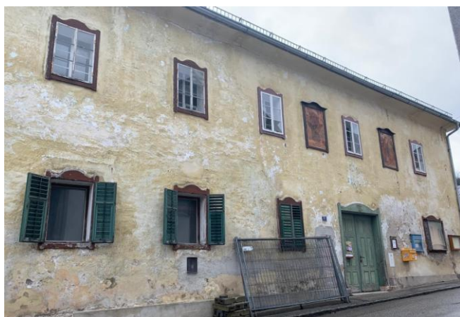
Der ruinöse Zustand des Gebäudes ist bereits von außen sichtbar.
